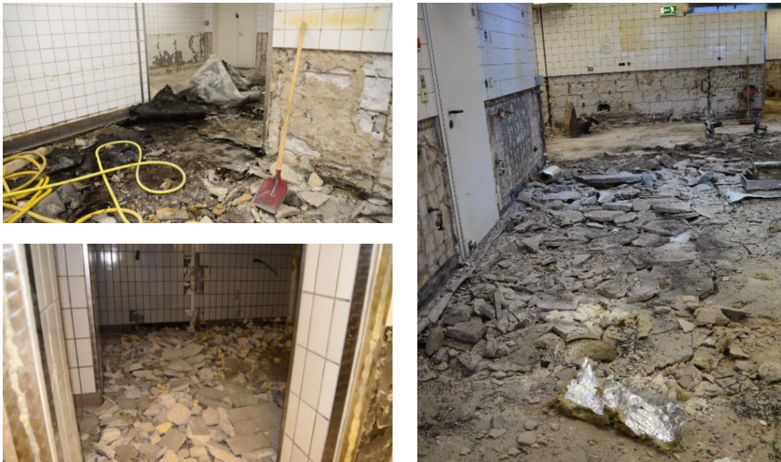
Abb. 1 - 3: Totalschaden der Fußbodenkonstruktion wegen falscher Detailplanung
