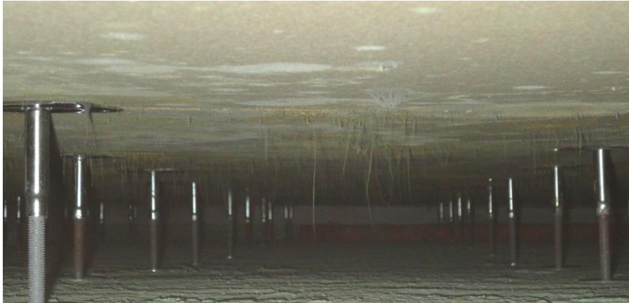
Abb. 10: Mikrobiell belasteter Hohlraumboden
