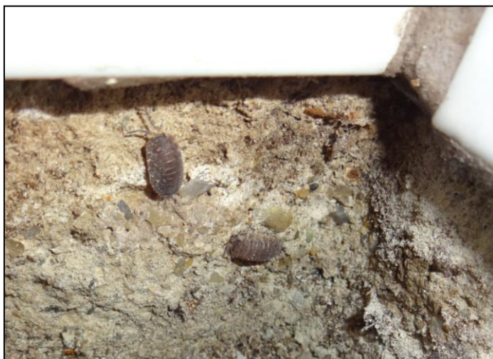
Abb. 9: Kellerasseln in der Fußbodenkonstruktion eines Bades
