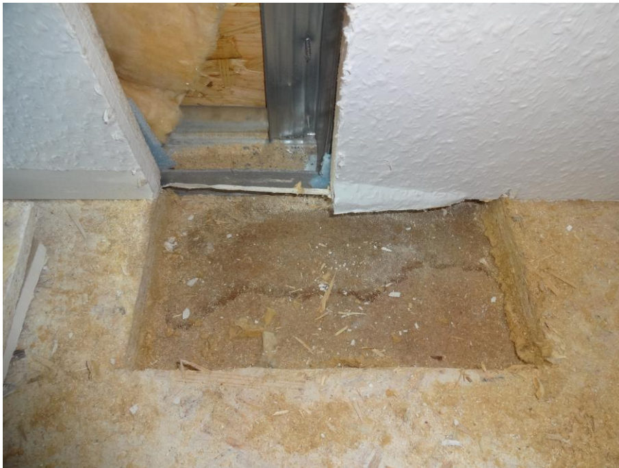
Abb. 1: Bestimmungswidriger Austritt von Wasser in die Fußboden-/Wandkonstruktion im Rahmen der Neuinstallation.
