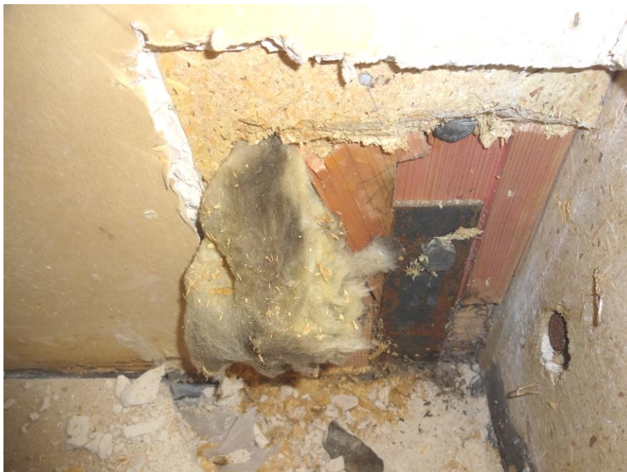
Abb. 3: Verfärbte Baumaterialien und verrostete Metallteile sind nach Bauteilöffnungen weitere Hinweise für zunächst nicht sichtbare Schimmelpilz-/ Bakterienbelastungen.
