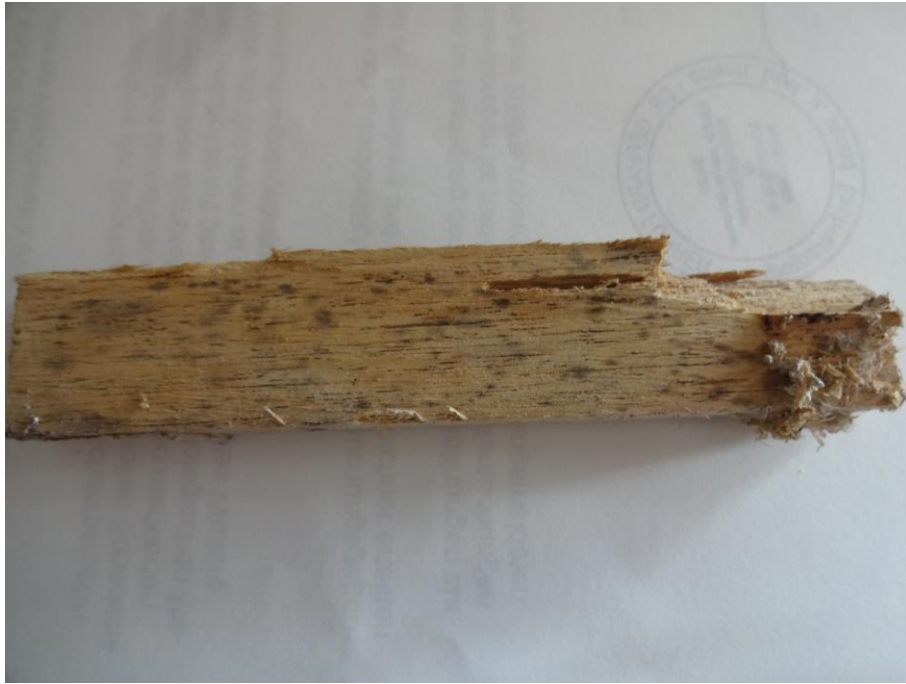
Abb. 4: Erst die mikroskopische und/ oder kultivierungstechnische Untersuchung auf Schimmelpilze und Bakterien an Materialien aus Dämmebenen oder anderen Hohlräumen gibt die Sicherheit, dass ein mikrobielle Schaden vorliegt oder auszuschließen ist. Im konkreten Fall sind die Verfärbungen unter dem Mikroskop auf Schimmelpilzwachstum in einer Holzständerwandkonstruktion einer Außenwand zurückzuführen.
