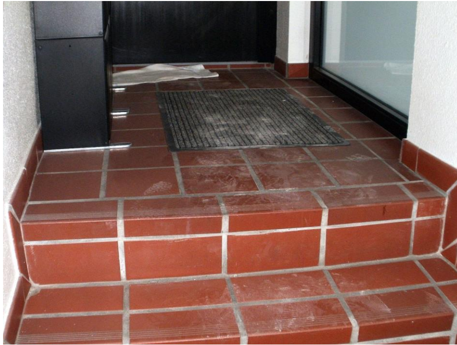
Abb. 3: Extreme Verstaubung hinter der Staubschutztüre
